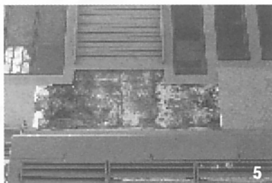
ภาพที่ 4-5 ผนัง EIFS ซึ่งไม่สามารถสังเกตความผิดปกติได้อย่างชัดเจน แต่เมื่อรื้อผนังดูจะเห็นปัญหาความชื้นที่ซ่อนอยู่ข้างใน (ที่มาภาพ : www.thehomeinspector.com )
