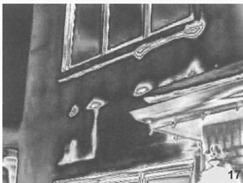
ภาพที่ 16-17 การสำรวจปัญหาความชื้นในผนัง EIFS โดยใช้ Thermography ทำให้สามารถเห็นจุดที่ความชื้นสะสมในผนัง (ที่มาภาพ : www.callpie.com/Services/IR_Thermography.htm )
