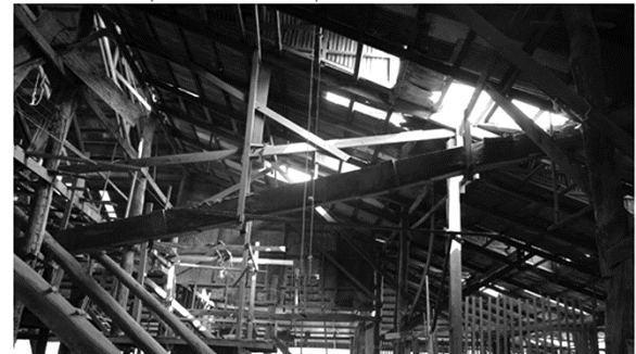
รางเพื่อระบายแกลบสู่ภายนอกอาคาร
