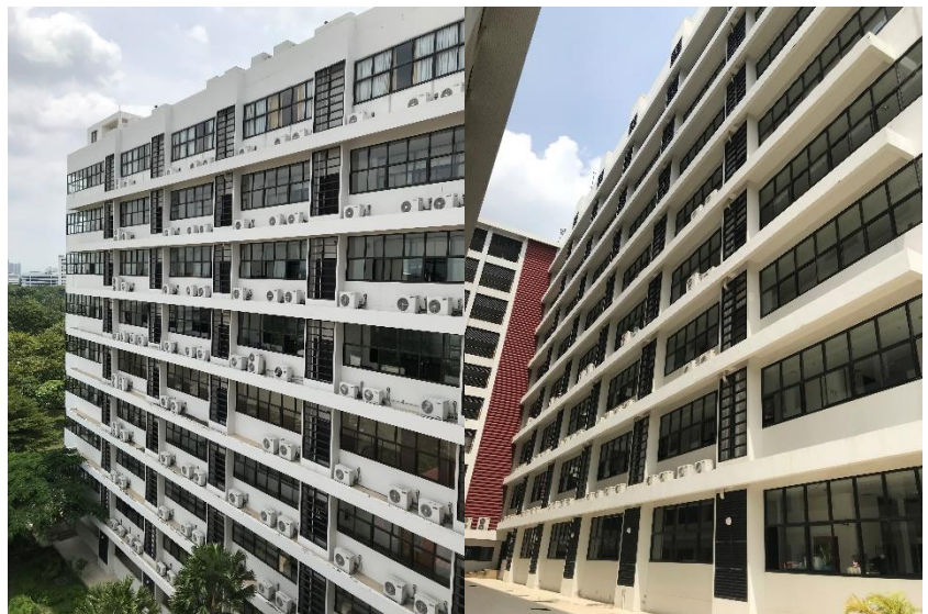
เครื่องปรับอากาศเป็บบแบบแยกส่วนที่ไม่ได้เบอร์ 5 วางที่บริเวณกันสาด
