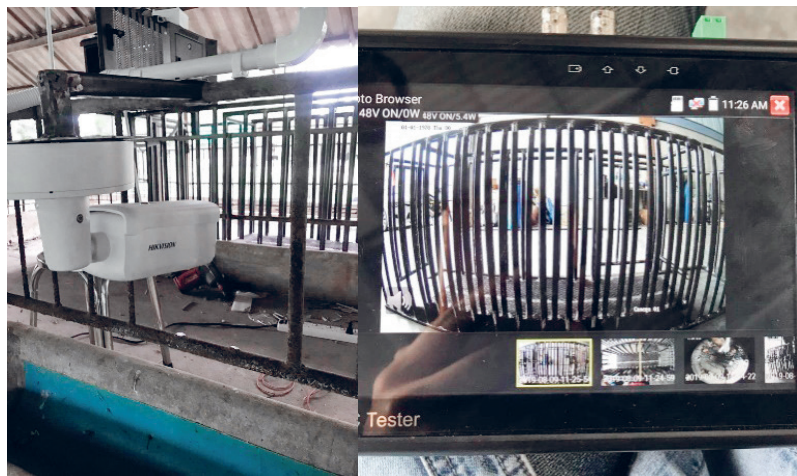
ภาพที่ 7 การติดตั้งในระดับภาคอุตสาหกรรมบริเวณด้านข้าง
