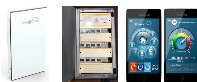
ภาพที่ 8 การติดตั้งเซอร์กิตเบรกเกอร์ HoME@Cloud ในบ้านพักอาศัยและแอปพลิเคชัน
