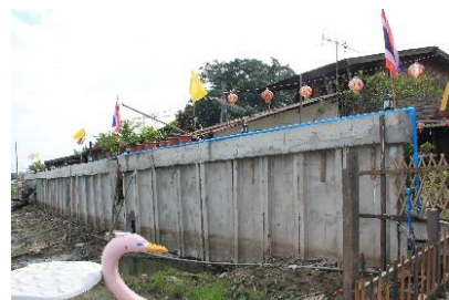
รูปที่ 7 เขื่อนคอนกรีตกันตลอดแนว ที่ตลาดปากคลอง รังสิตคลอง 3
