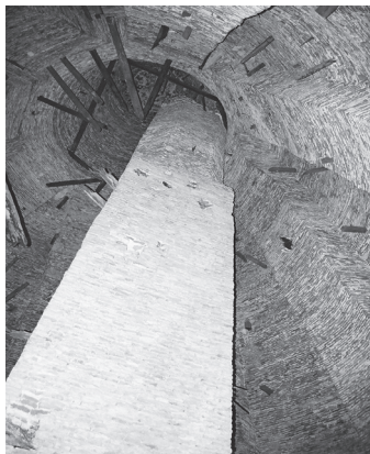
รูปที่ 6 ภาพเสาก่ออิฐแกนกลางหักและเอียงพังผนังเจดีย์ เป็นสาเหตุที่ทำให้เกิดน้ำหนัก กดทับ ทำให้องค์พระบรมธาตุเจดีย์เอียง นอกจากนี้ยังมีไม้คานซึ่งพาดระหว่างเสาแกนกลางกับผนังเจดีย์ สันนิษฐานว่าคานไม้เหล่านี้ทำหน้าที่เป็นนั่งร้านที่ใช้ในการลำเลียงวัสดุก่อสร้างขึ้นไปในแต่ละระดับ
