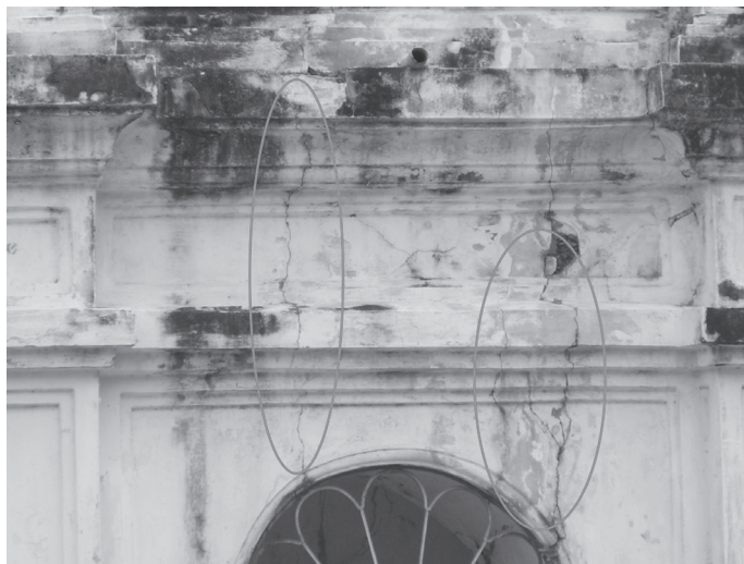
รูปที่ 3 สภาพผนังรอบเจดีย์เกิดรอยแตกร้าวมีคราบเชื้อราและตะไคร่น้ำ
