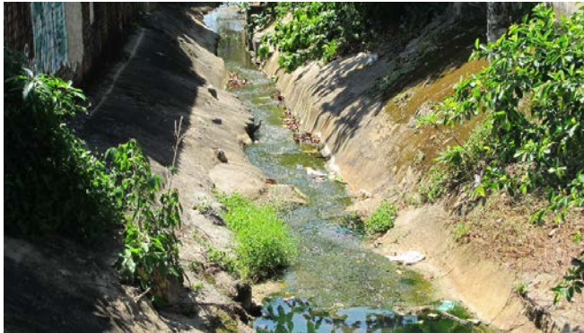
รูปภาพ น้ำเสียจากโรงแรมถูกทิ้งลงทะเลผ่านทางระบายน้ำ
