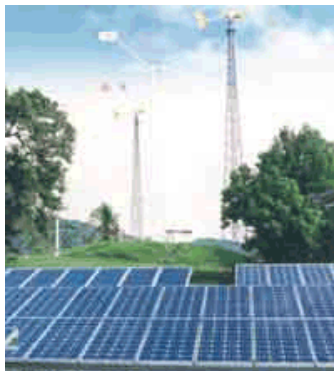
ภาพที่ 2 กังหันลมและเซลล์แสงอาทิตย์ใช้ผลิตกระแสไฟฟ้า ณ สถานีพลังงาน ทดแทนพรหมเทพ
